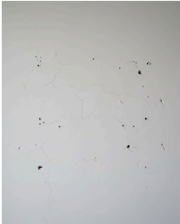
Texto Imagen 1: "Error #1: Pintar directamente sobre grietas o agujeros."
